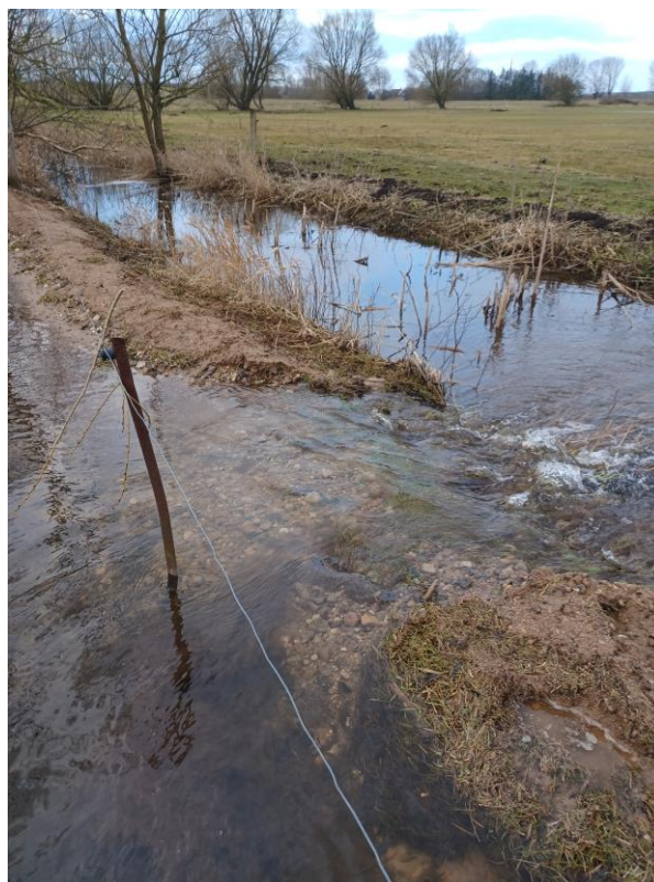
Foto 4. Brud på kanten med overløb til Fladså.
