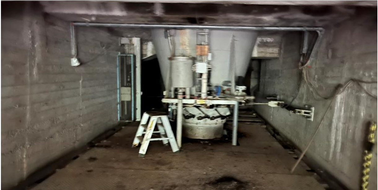
Figur 36. Turbine og installationer ved udløb fra kraftværket.
